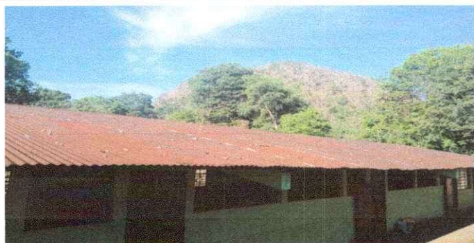
Foto1: Se observa el deterioro del entechado de la escuela.
